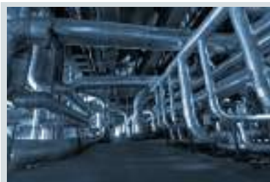
Trạm cung cấp khí
