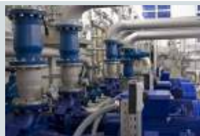
Trạm bơm nước
